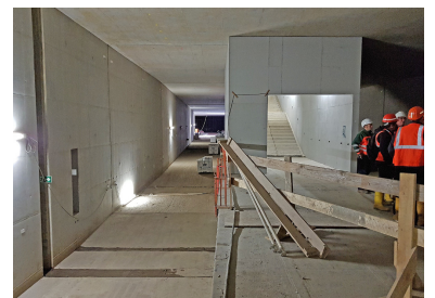
Das Nordende des Bahnsteigs mit Blick in den Gleisstroß Richtung Wedding. Der Treppenzugang wird für die Verlängerung Richtung Potsdamer Platz wieder abgerissen. (Foto: Florian Müller, Oktober/November 2018)
