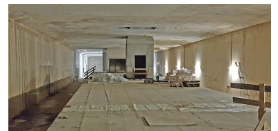
Der provisorische Tunnelbahnhof der S 21 unter der Invalidenstraße. Links der Gleisstroß für die S-Bahn, rechts der Gleisstroß für Logistikzüge. Der Aufzugschacht (im Hintergrund) steht zu dicht an der Bahnsteigkante und erlaubt keinen Personenverkehr auf dem Gleis. (Foto: Florian Müller, Oktober/November 2018)
