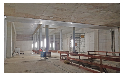
Das Zwischengeschoss über dem provisorischen Bahnsteig, Blickrichtung Süd. Rechts hinter der Wand befindet sich die Passarelle der U 55, zu der es Durchgänge geben wird. Die Treppe rechts führt hinab zum Südende des provisorischen Bahnsteigs. (Foto: Florian Müller, Oktober/November 2018)
