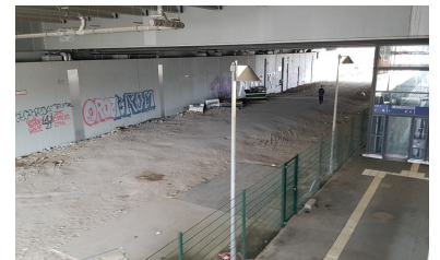
Baustelle Straßenbahn: Wohl noch Jahre wird es dauern, bis auf dieser Fläche neben den Regionalbahnsteigen der Ostbahn endlich Straßenbahnen halten. Das Planfeststellungsverfahren für die Verlegung der Trasse von der Boxhagener in die Sonntagstraße kommt nur langsam voran. (Foto: Florian Müller)
