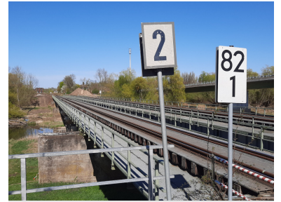
Ab Dezember 2020 beginnt der dringend notwendige Ersatzneubau der Brücken über die Odervorflut (hier im Bild) und die Oder. Zu den vorbereitenden Arbeiten gehört u. a. die bereits laufende Kampfmittelräumung. (Foto: Christian Schultz)
