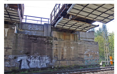
Das Kreuzungsbauwerk der Dresdener Bahn mit dem Berliner Außenring ist für eine Zweigleisigkeit der S-Bahn bereits vorbereitet. Das Bauwerk wird abgerissen und für zwei Fernbahngleise und nur ein S-Bahn-Gleis neu gebaut.
